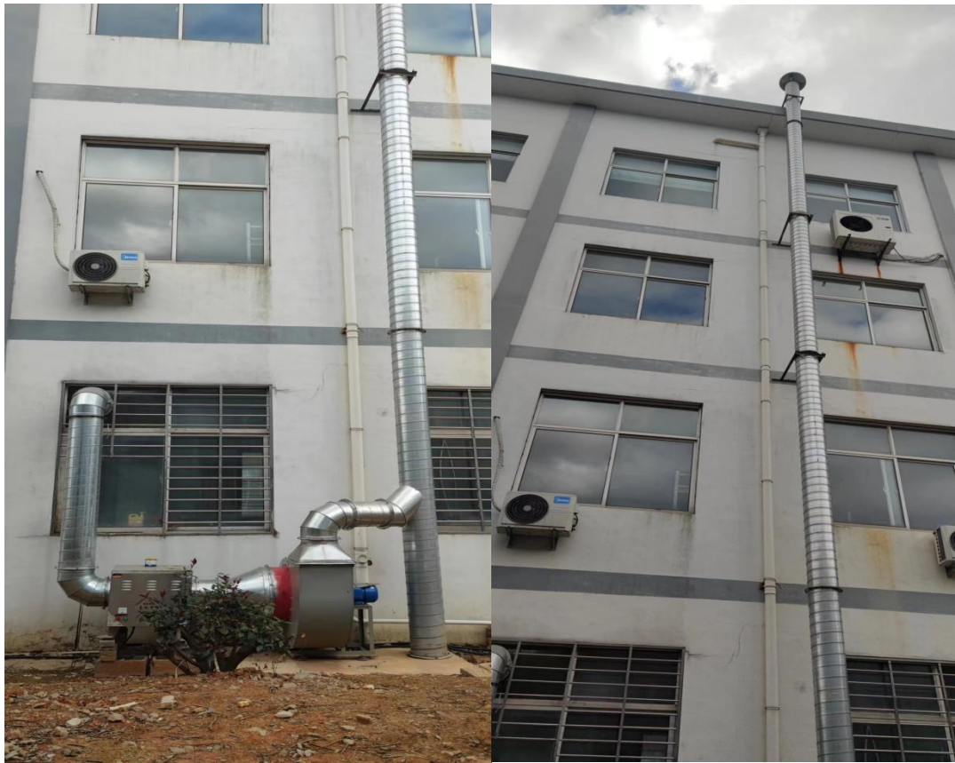
图 3-10 油烟处理设施及管道
